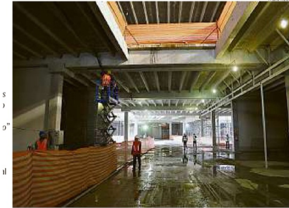
A todo vapor. De acordo com a Multiplan, mais da metade das obras está concluída
